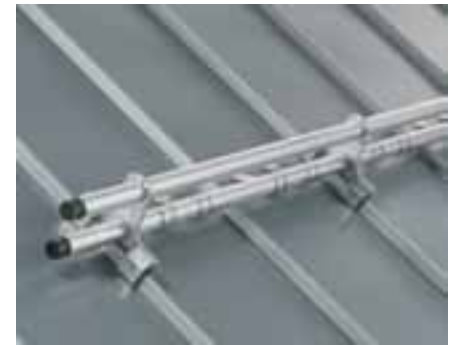
Beispiel Schneefang-Doppelrohrhalterung auf einer Zink-Stehfalzdacheindeckung.
