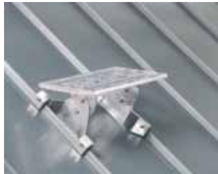
Beispiel Kurzrost auf einer Zink-Stehfalzdacheindeckung.
