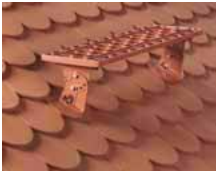
Beispiel Trittrost auf einer Biberschwanzdacheindeckung.
